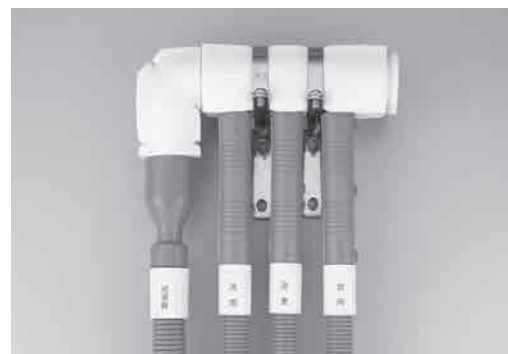
■給湯ヘッダー施工例 P31, P60
